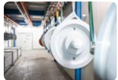
Nueva planta de secado con recuperación de calor
